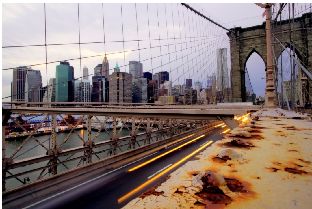
Slika 1. Korodirani dijelovi Brooklynskog mosta [2]
