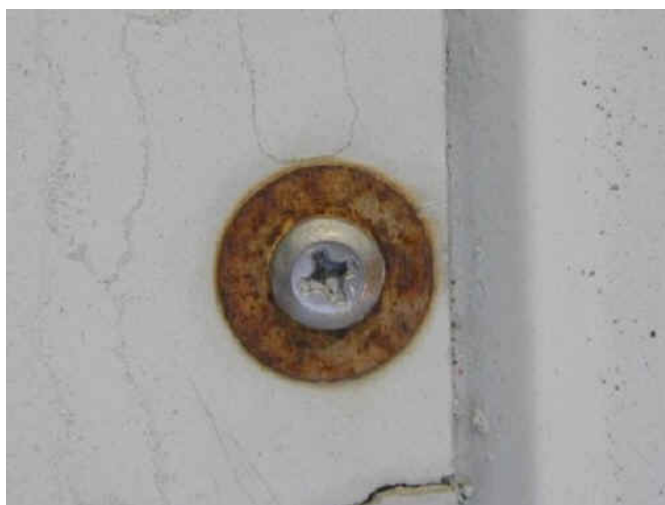
Slika 9. Galvanska korozija nastala zbog razlike potencijala između vijka i podloške [14]
