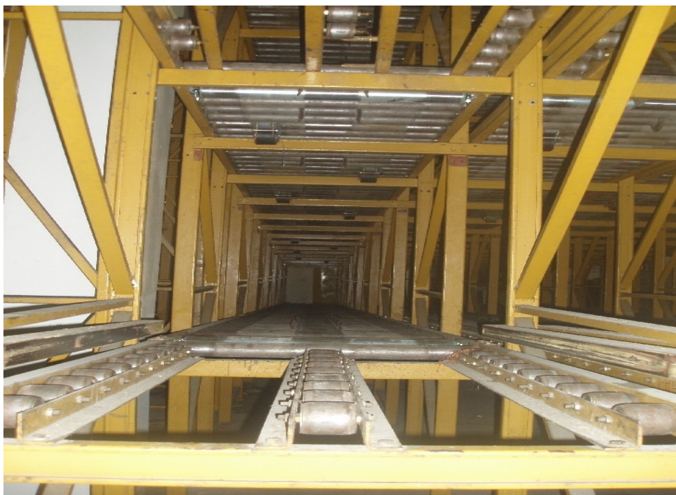
Slika 22. Tuneli valjčanih konvejera u skladištu
