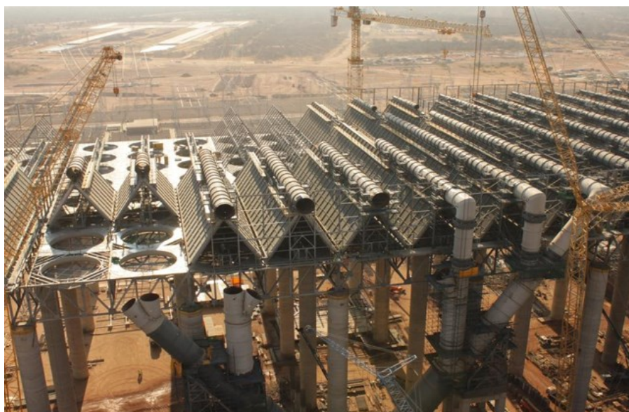
Slika 49. Prikaz izmjenjivačkih površina kondenzatora
