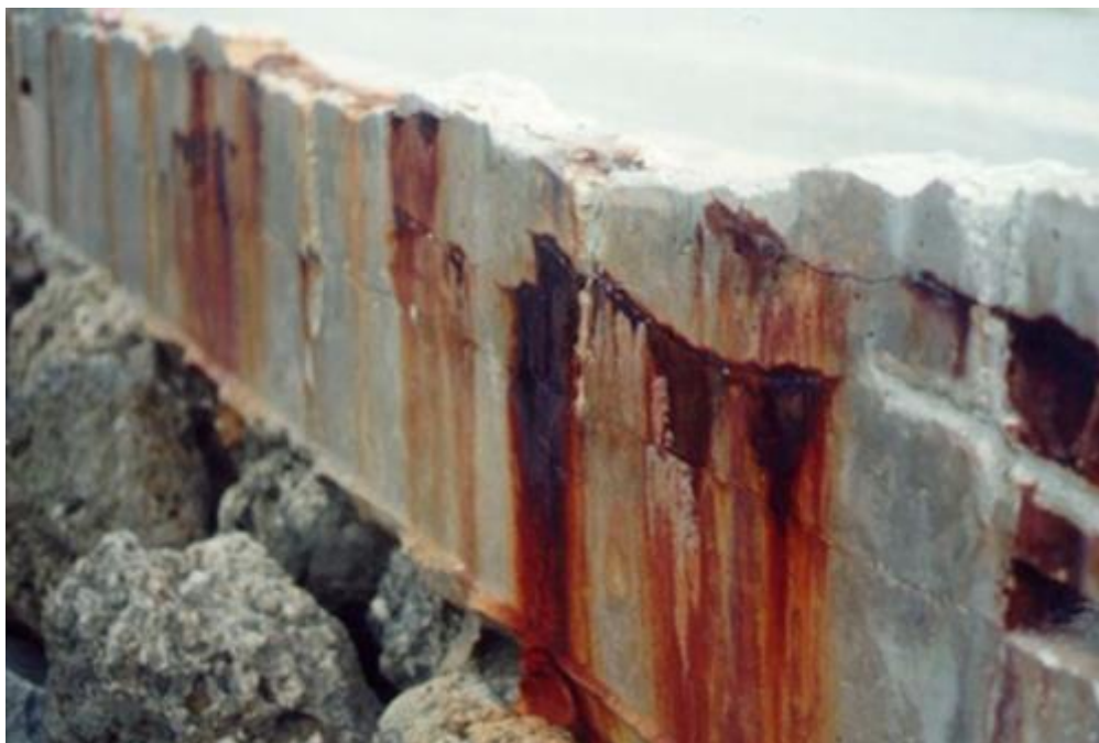
Slika 25. Korozija u morskoj atmosferi [21]
