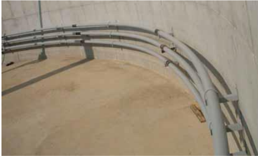
Slika 13. Cijevi za grijanje instalirane unutar fermentatora.
