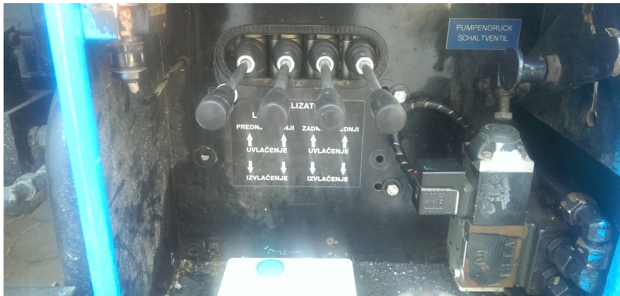
Slika 6. Ormar za nivelaciju platforme
