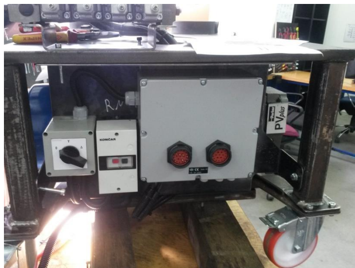
Slika 11. Elektroormar sa pripadajućim sklopkama
