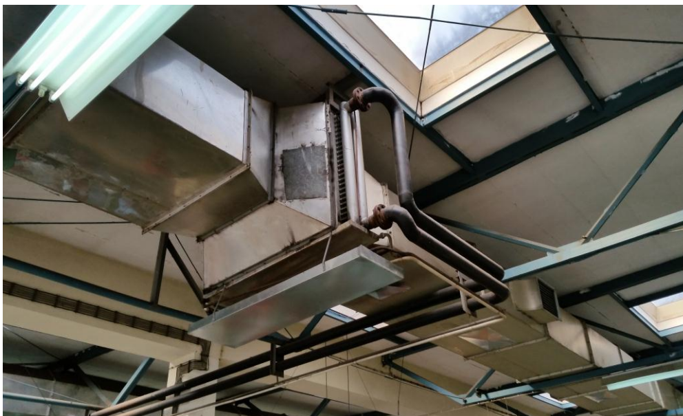
Slika 5.2. Hladnjak zraka ugrađen unutar ventilacijskog kanala, s okapnicom za odvod kondenzata, tvornica obuće »Bema« - Banja Luka.
