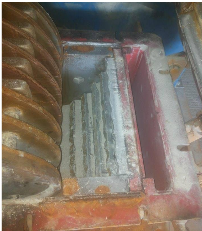
Slika 46. Udarne obloge ispod rotora u kućištu mlina
