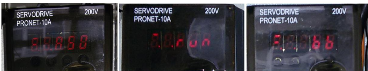
Slika 39. Ekran podređenog uređaja
