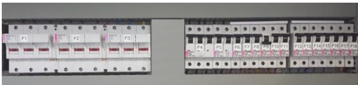
Slika 4.23 Zaštitne sklopke elemenata elektro-ormara
