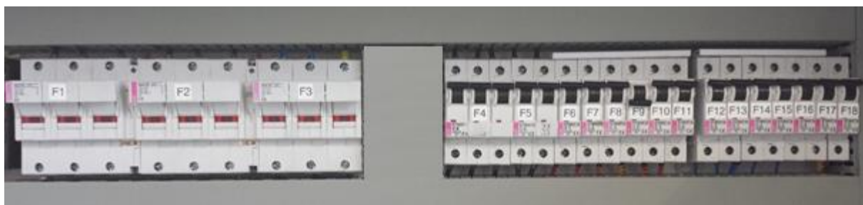
Slika 4.23 Zaštitne sklopke elemenata elektro-ormara
