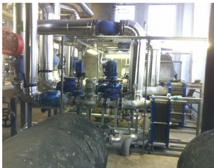
Slika 19. Prikaz centralne toplinske stanice na lokaciji Rebro
