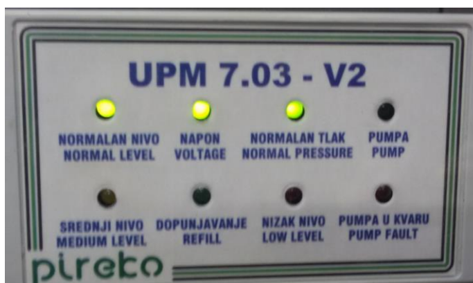
Slika 10. Indikatori ispravnosti rada hidrofora
