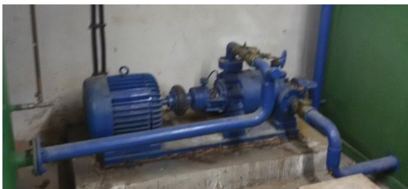
Slika 17. Motor za crpljenje vode iz spremnika
