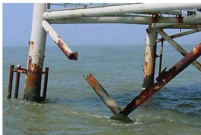
Slika 10. Korozija vjetroturbine u zoni valova [11]
