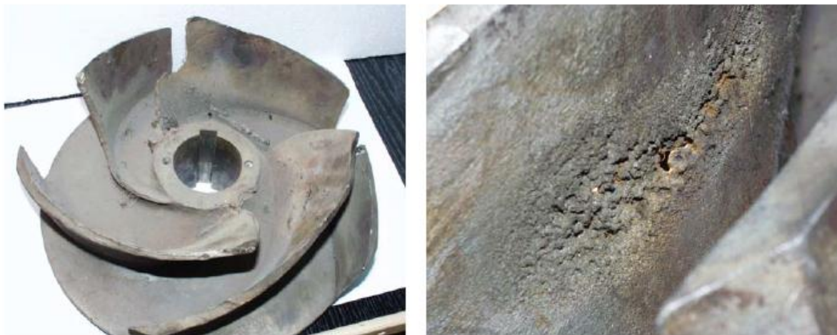
Slika 50. Kavitacijska erozija rotora centrifugalne pumpe [4]
