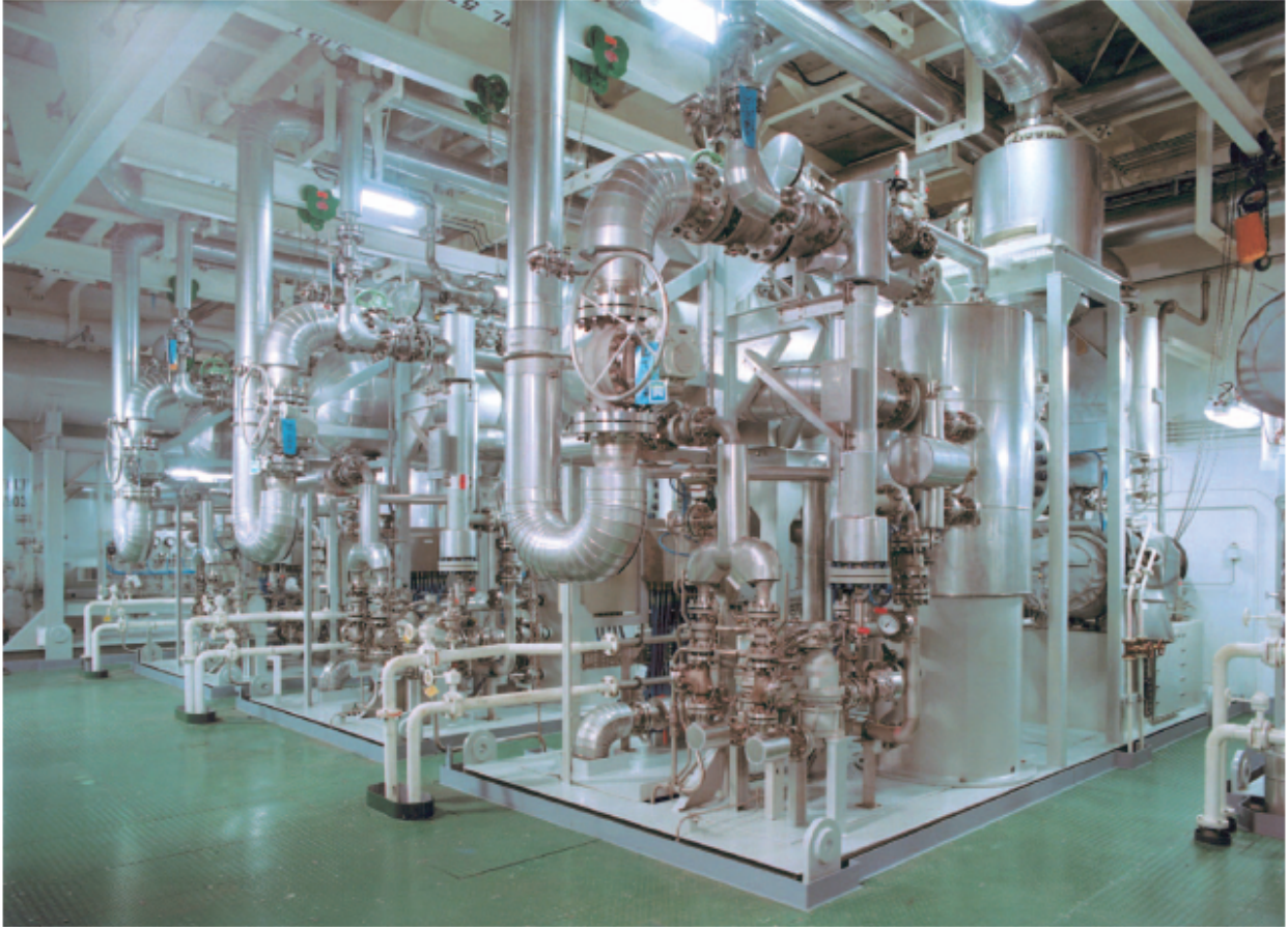
Slika 66: Postrojenje za ponovno ukapljivanje isparenog prirodnog plina na LNG tankeru
