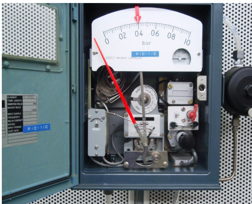
Slika 4.11. Unutrašnjost PID regulatora tlaka FOXBORO
