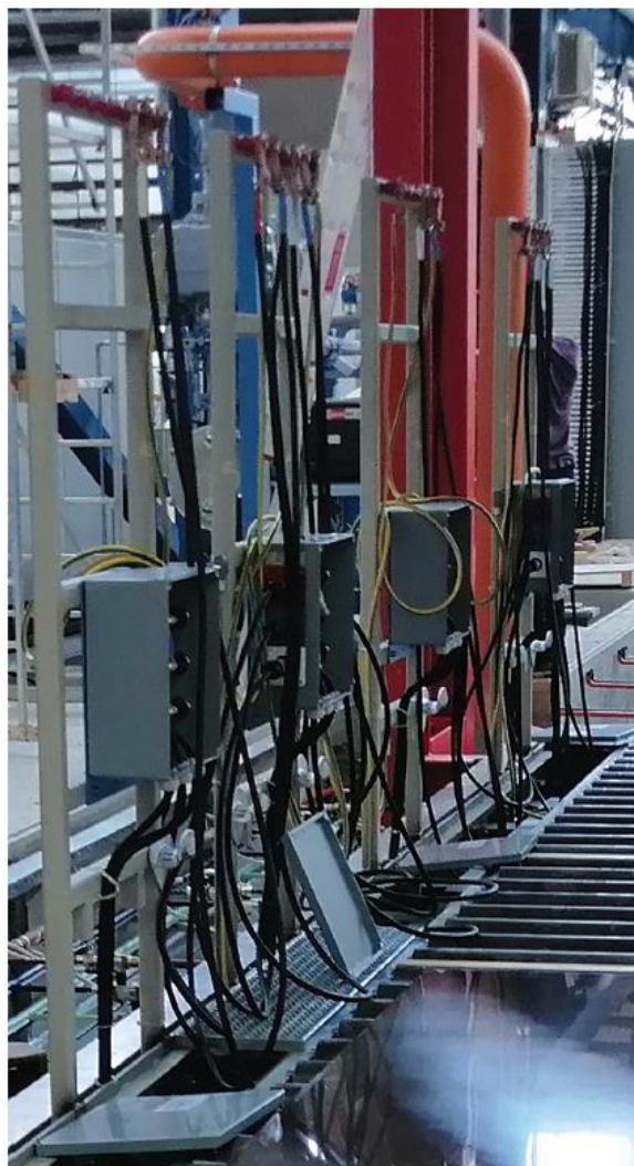
Slika 25. Pultovi za ispitne kablove
