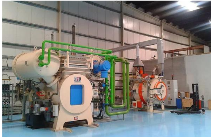
Slika 10. Postrojenje za nitriranje u plinu [10]
