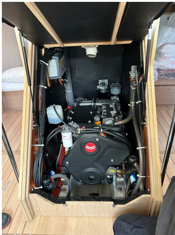
Slika 27. Dostupan prostor u unutrašnjosti motornog prostora
