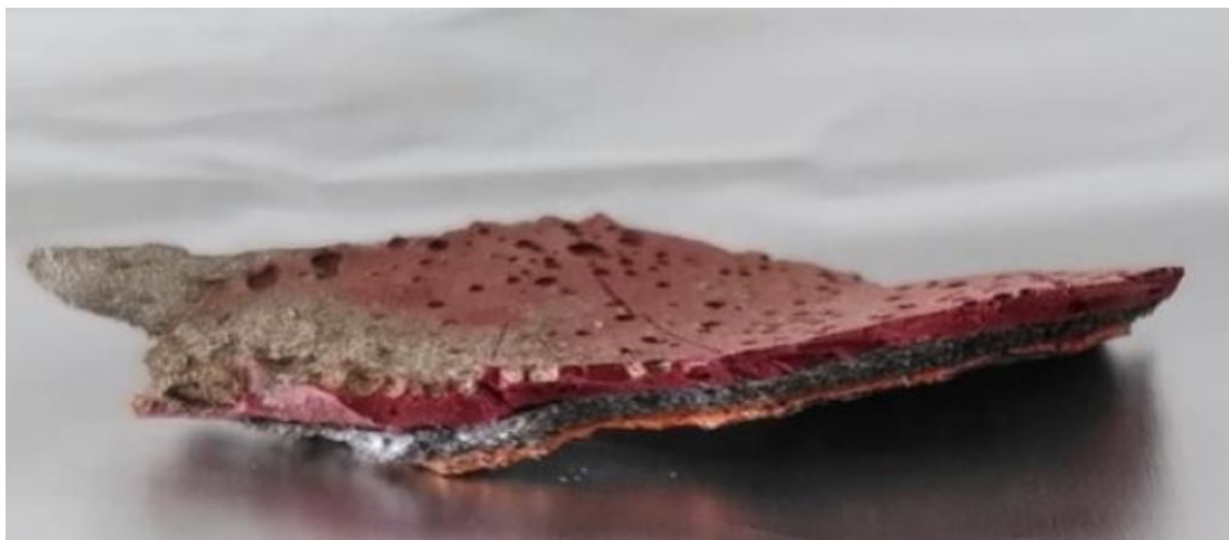
Slika 2. Dio sustava premaza odlomljen s konstrukcije [3]
