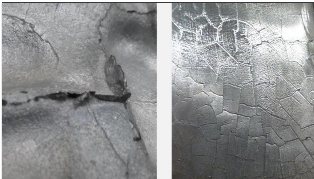
Slika 26 Pukotine na kalupu
