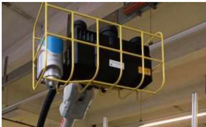
Slika 9. Zaštitna konstrukcija sa senzorima na prihvatnici robota
