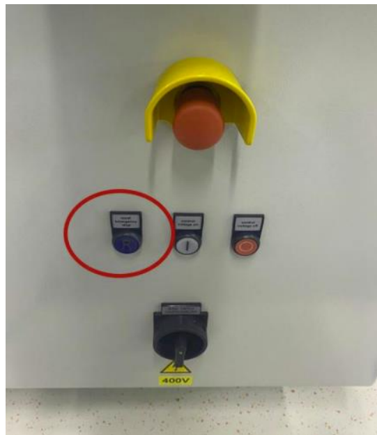
Slika 18. Uključivanje glavnog PLC-a.
