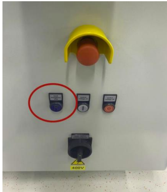
Slika 18. Uključivanje glavnog PLC-a.
