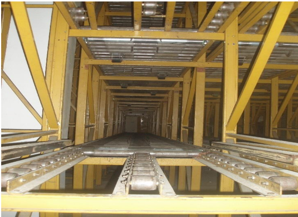
Slika 20. Tuneli valjčanih traka u skladištu
