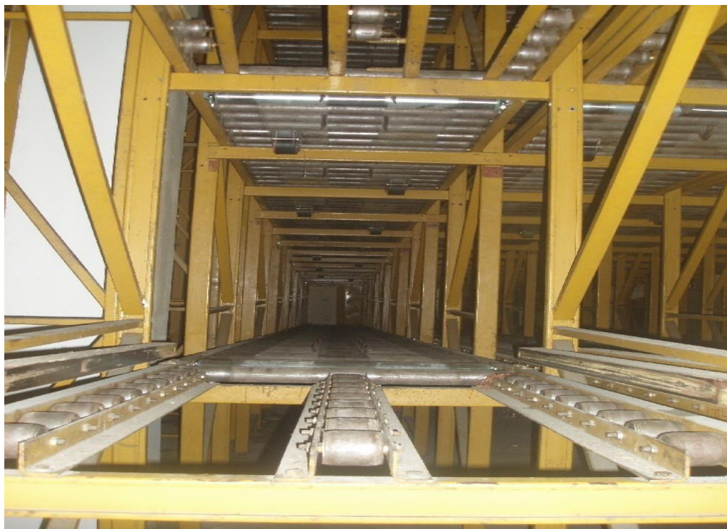
Slika 20. Tuneli valjčanih traka u skladištu
