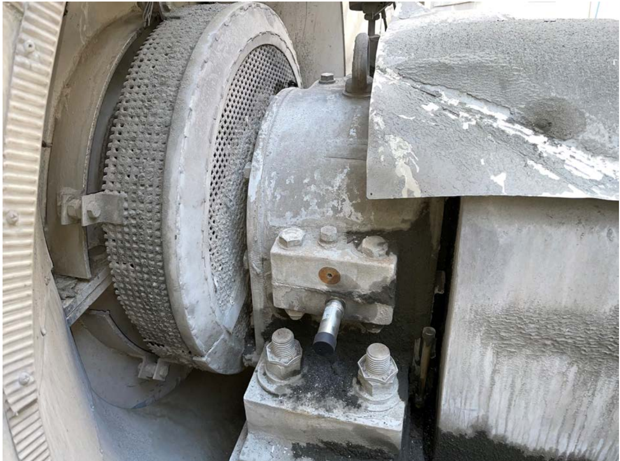
Slika 36. Montirani senzor na ležaju ventilatora [11]
