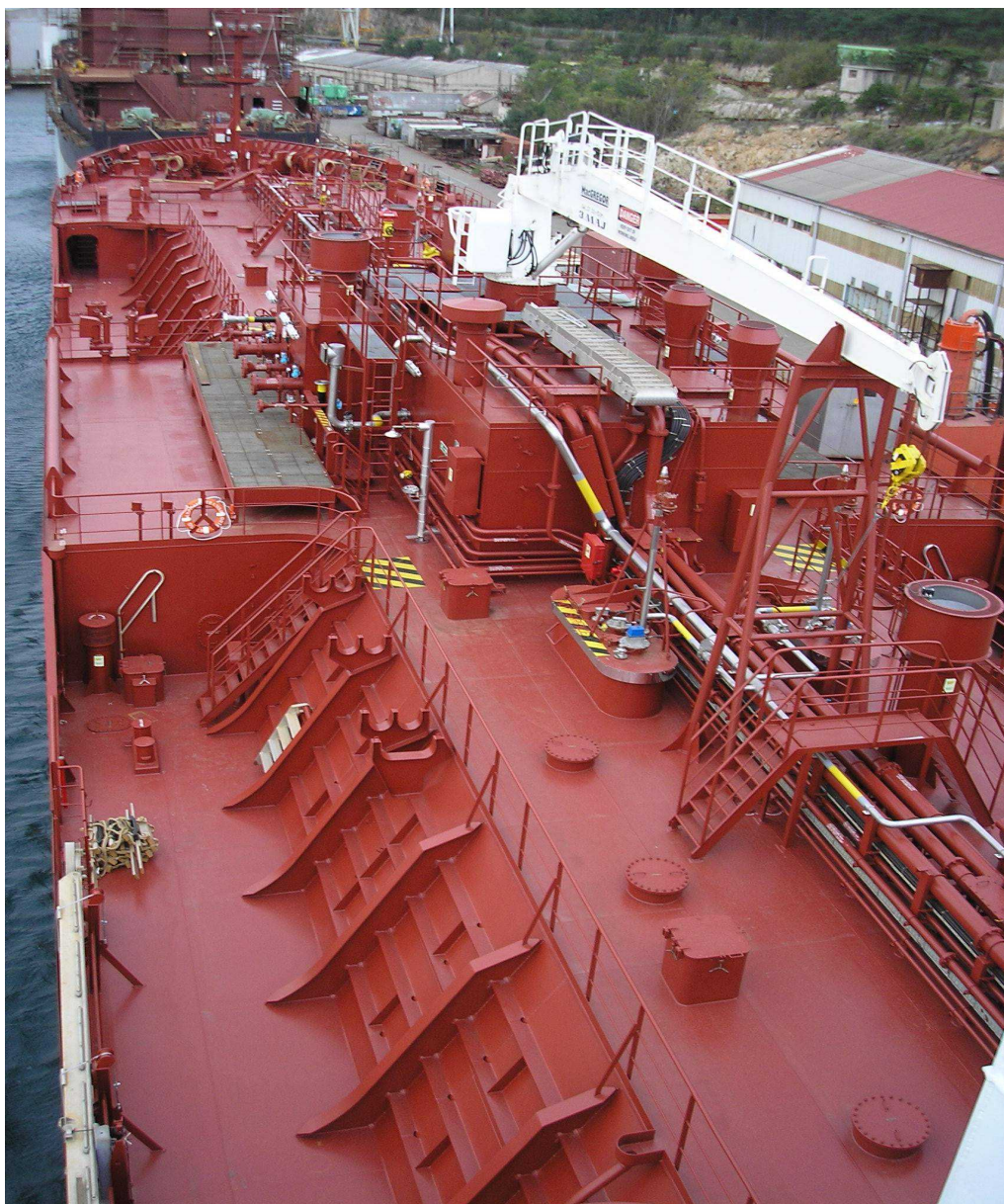
Slika 90 Nadvišena paluba s kućicom pumpne stanice
