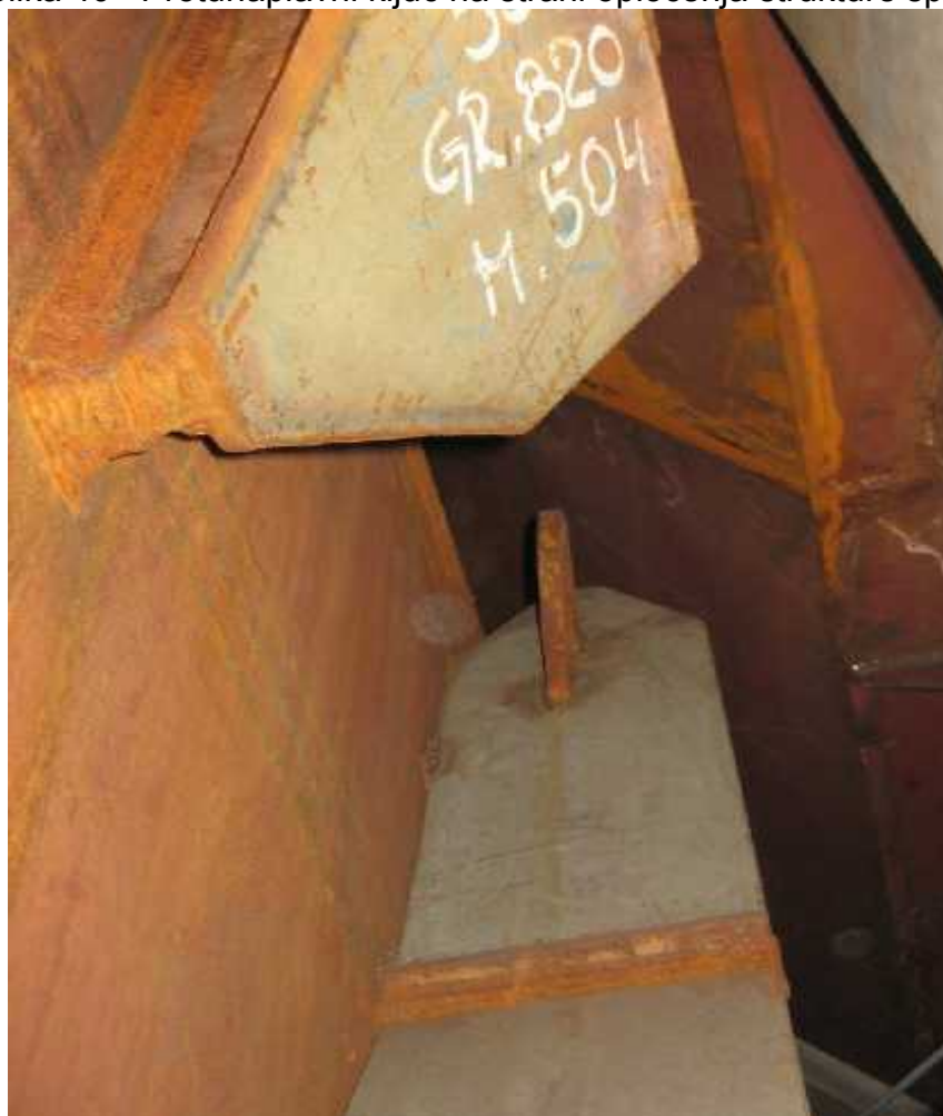
Slika 41 Protunaplavni ključ na strani krilnih balastnih tankova
